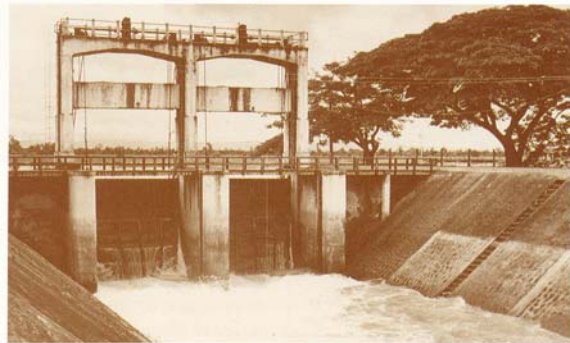
ประตูระบายน้ำ
