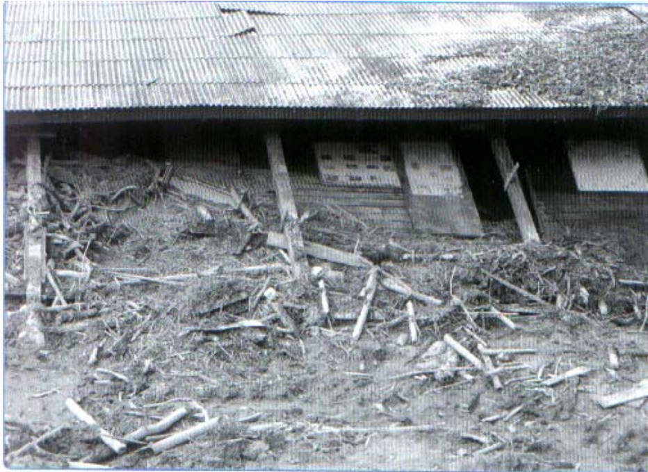
โคลนถล่มอาคารเรียน อ.วังชิ้น จ.เพชรบูรณ์
