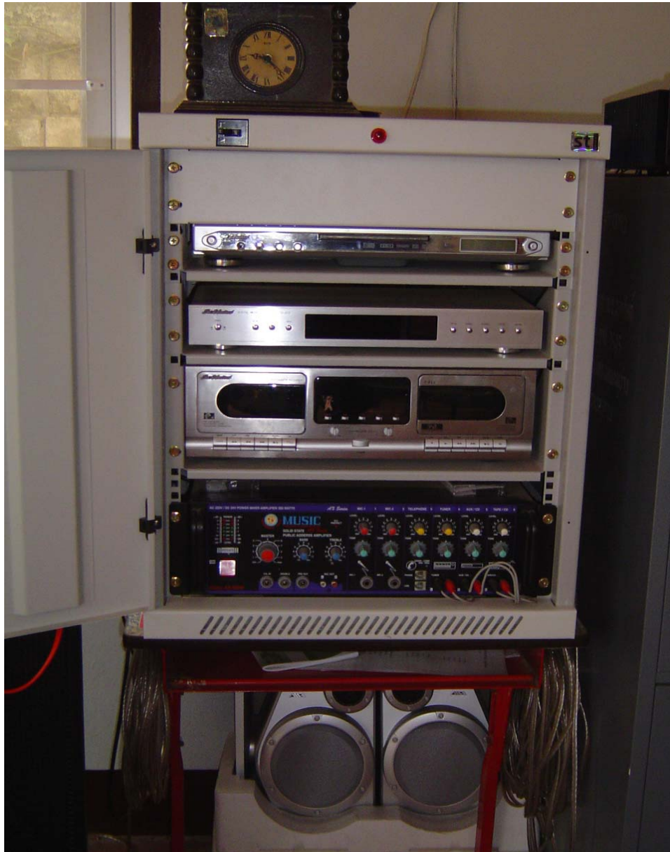
ภาพที่ 2.3.1 ข การติดตั้งอุปกรณ์ในตู้อุปกรณ์ (RACK) เรียงตามลำดับจากชั้นล่างสุด เครื่องขยายเสียง เครื่องเล่นเทป จูนเนอร์ และ เครื่องเล่นซีดี
